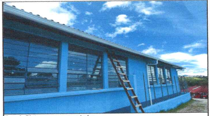
Foto 2: Pintura en muros exterior.
