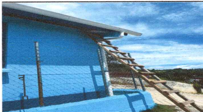
Foto 2: Sustrucción de agua pluvial
