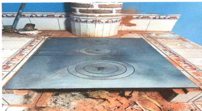
Foto 3: susutitución de plancha de metal.
