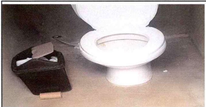
Foto 6: SERVICIOS SANITARIOS Y SUS ACCESORIOS
