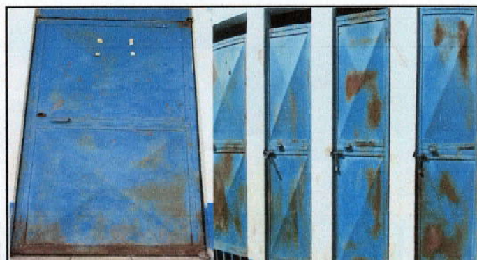
Foto 3: PUERTAS DE METAL (1 Aulas + 1 Cocina + 4 Baños).
