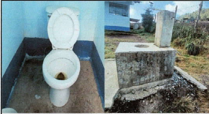
Foto 7: SERVICIOS SANITARIOS Y SUS ACCESORIOS
