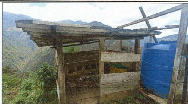
Foto 3: Pilares de bodega podridas.
