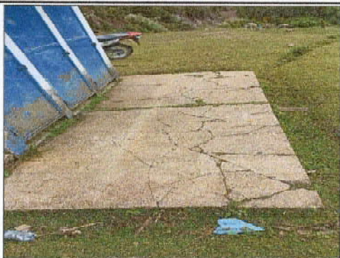
Foto1: Piso frontal del baño rajado.
