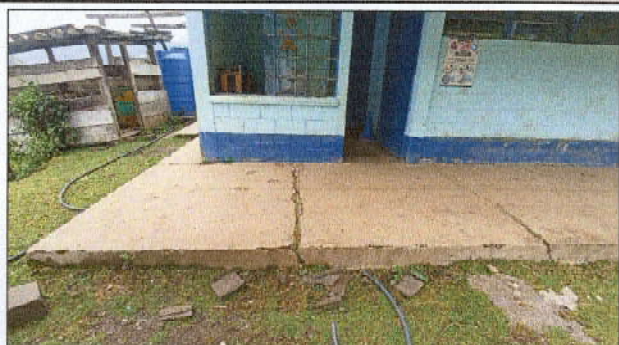
Foto 5: Piso del corredor cuarteado y rajado.
