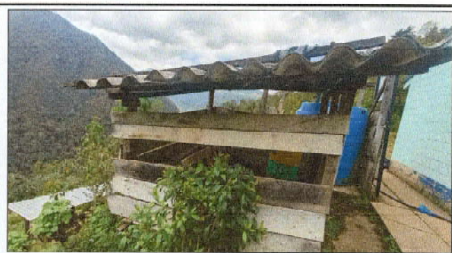
Foto 4: Techo y paredes de bodega en mal estado.
