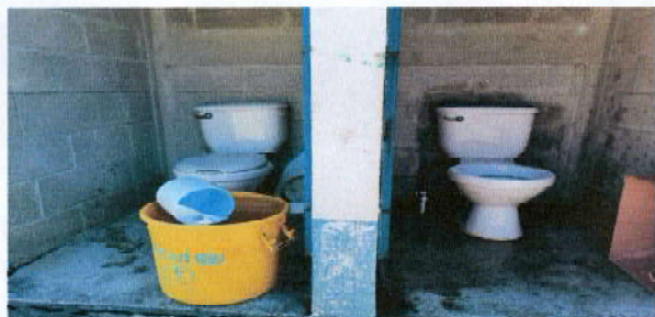
Foto 7: Servicios sanitarios y sus accesorios
