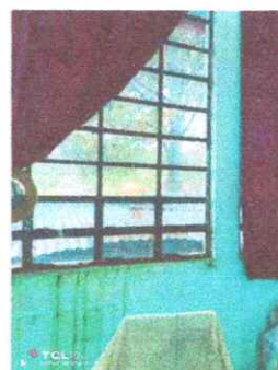
Foto 4: pintura en muros de INEB de Telesecundaria interior
