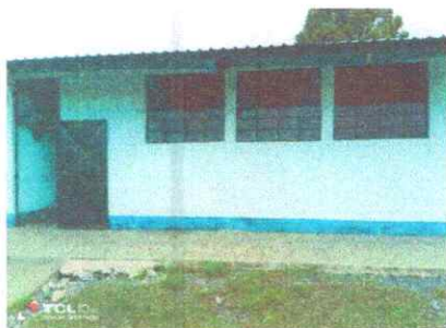
Foto 3: Pintura en muros de INEB De Telesecundaria, exteriores
