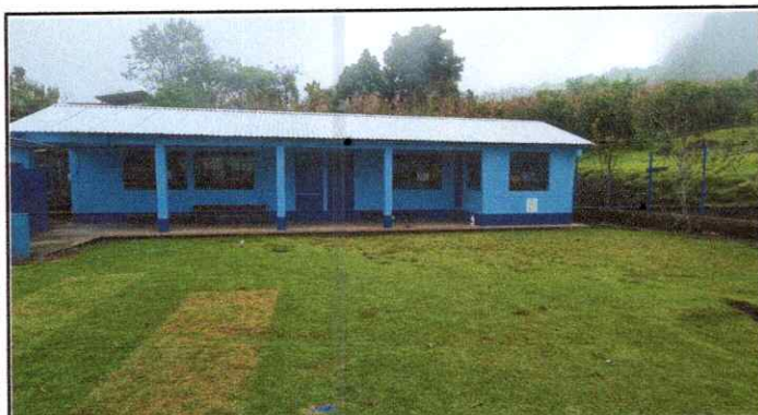
Foto 3: SON LAS 2 AULAS Y DIRECCION QUE SE NECESITA CAMBIARLE DE TECHO, Y UNA PINTADA, REEMPLAZO DE ALGUNOS VIDRIOS.
