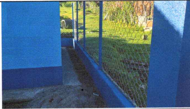
Foto 4: CIRCULACION DE LA ESCUELA CON MALLA QUE SE NECESITA CAMBIAR.
