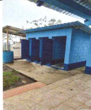
Foto 2: 3 BAÑOS QUE NECESITA UNA PINTADA, CAMBIO DE TECHO.
