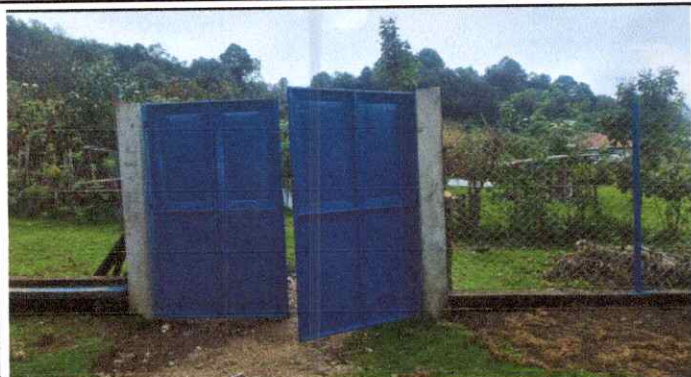
Foto 1: ENTRADA DE LA ESCUELA CON PORTON YA DESPINTADA Y EL TECHO CASI ESTA POR CAER.
