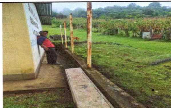
Foto 4: CIRCULACION DE LA ESCUELA CON MALLA QUE SE NECESITA CAMBIAR.
