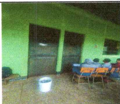
Foto 5: PUERTAS DE LAS AULAS QUE SE NECESITAN UN MANTENIMIENTO.
