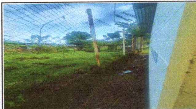
Foto 4: CIRCULACION DE LA ESCUELA CON MALLA QUE SE NECESITA CAMBIAR.
