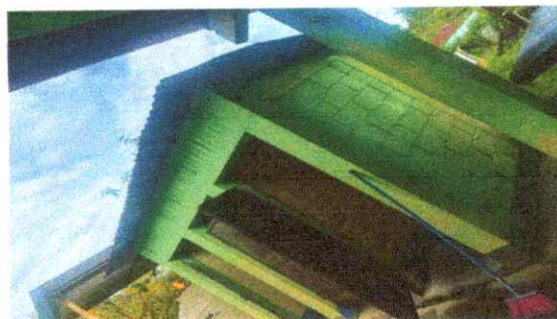
Foto 2: 3 BAÑOS QUE NECESITA UNA PINTADA, CAMBIO DE TECHO.
