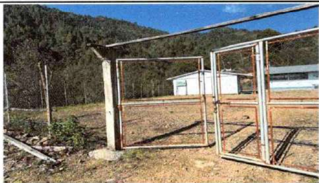
Foto 1: El portón actual se encuentra en mal estado y oxidado, lo que compromete la seguridad y la visibilidad del acceso. Para abordar esta situación, se propone reemplazar el portón existente por uno nuevo de lámina.
