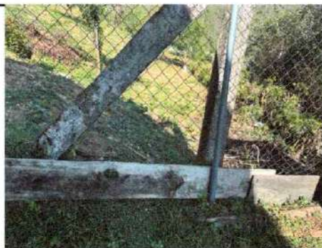
Foto 10: Es importante reemplazar los tubos actuales y asegurar su base de manera adecuada, ya que actualmente están asegurados con madera, lo que puede no ser lo suficientemente seguro o durable.
