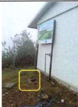
Foto 7: Actualmente, nuestro establecimiento no cuenta con un sistema de drenaje adecuado, lo que puede generar problemas de higiene y seguridad. .
