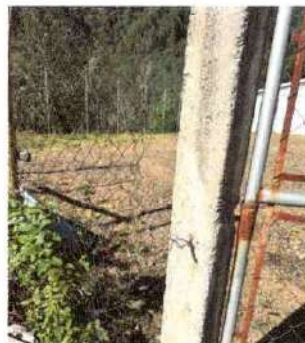
Foto 8: Nuestro muro actualmente presenta daños en la malla, lo que compromete la seguridad y el resguardo de los bienes inmuebles y de los estudiantes. Por lo tanto, es fundamental reemplazar la malla dañada para
