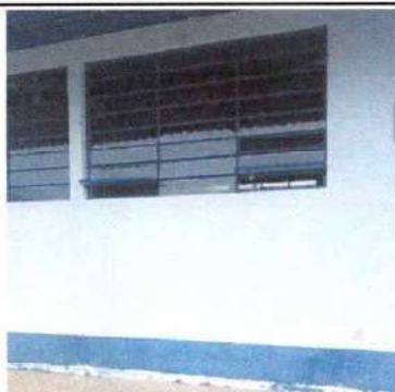
Foto 3: Debido a las condiciones climáticas adversas y algunos accidentes, algunos vidrios se han roto y es necesario reemplazarlos. El reemplazo de los vidrios rotos es fundamental para restaurar la seguridad, la funcionalidad y la apariencia del espacio.
