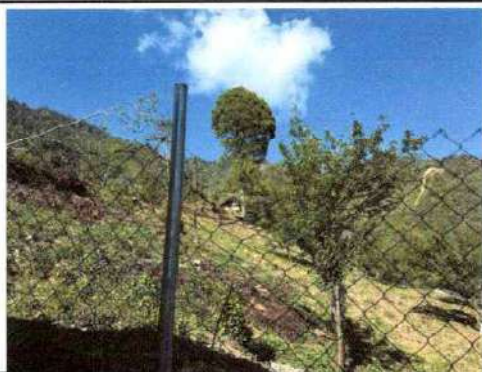
Foto 9: Nuestro muro actualmente presenta daños en la malla, lo que compromete la seguridad y el resguardo de los bienes inmuebles y de los estudiantes. Por lo tanto, es fundamental reemplazar la malla dañada para mejorar la seguridad y protección.
