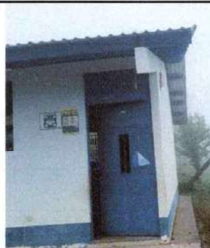
Foto 2: La puerta actual se encuentra en mal estado y no cuenta con llaves, lo que compromete la seguridad y la funcionalidad del acceso. Para abordar esta situación, se propone reemplazar la puerta existente por una nueva.
