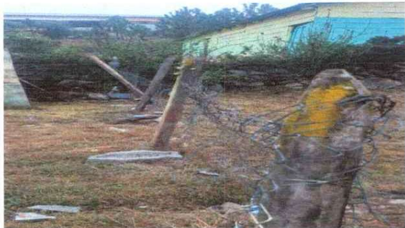
Foto No. 1. Malla y postes en mal estado
