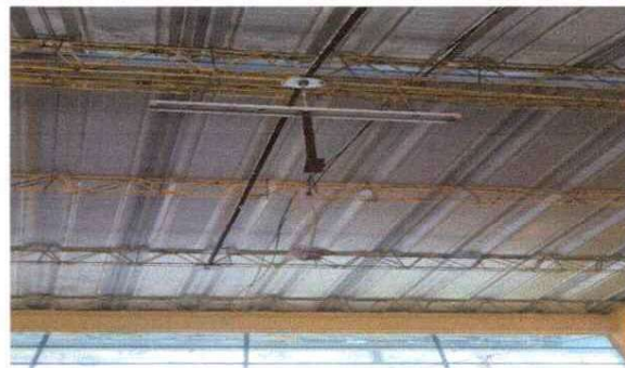
Foto No 2. Lámparas y cableado en mal estado
