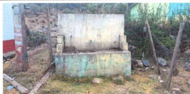
Foto No 6. Repello en mal estado
