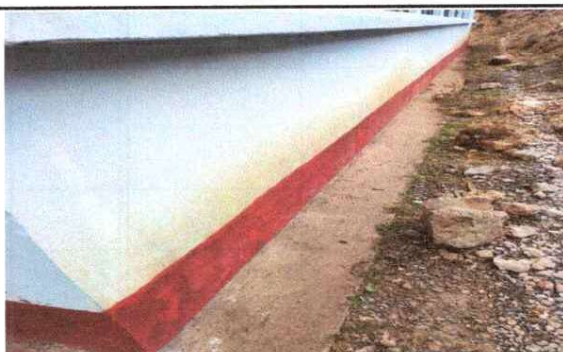
Foto No 11. Pintura en mal estado
