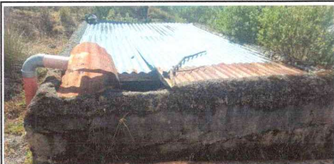
Foto No 7. Sisterna en mal estado
