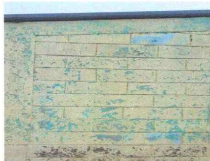
Foto No 10. Repello en mal estado
