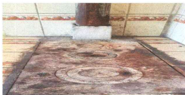
Foto No 8. Plancha en mal estado
