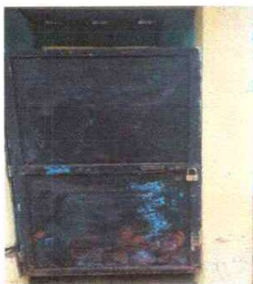
Foto No 3. Puertas en mal estado
