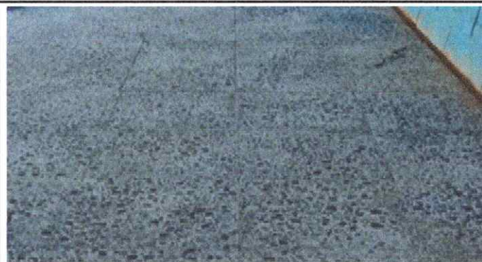
Foto 2 Sustrucción de piso de granito
