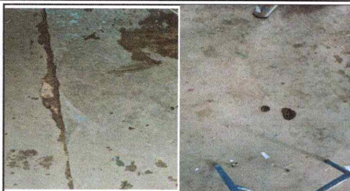
Foto 2 Sustrucción de piso de granito
