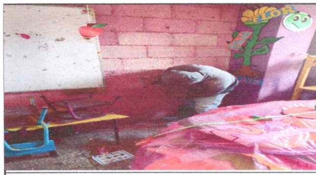
Foto 6: Paredes en mal estado
