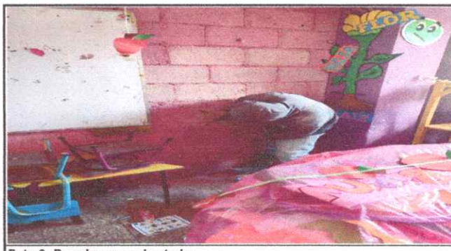
Foto 6: Paredes en mal estado
