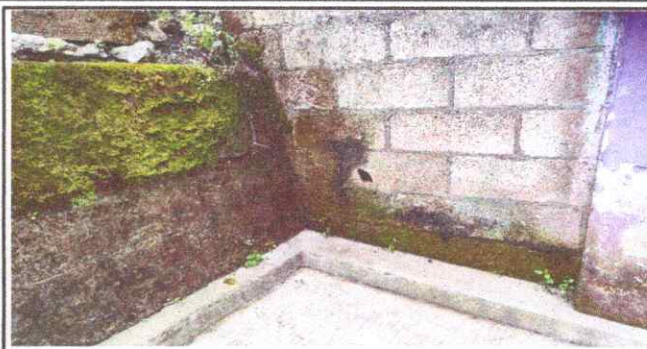
Foto 2: paredes en mal estado
