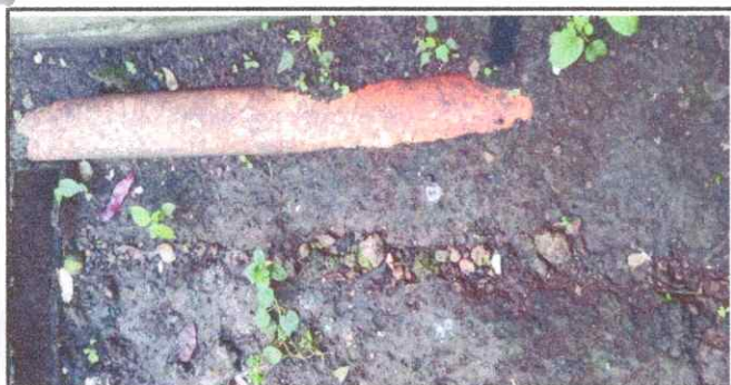
Foto 5: Tubería PVC línea principal aguas negras en mal estado
