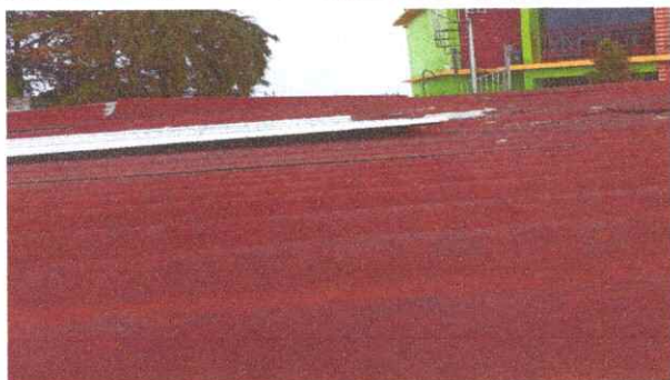
Foto1: Sustrucción de laminas en mal estado.
