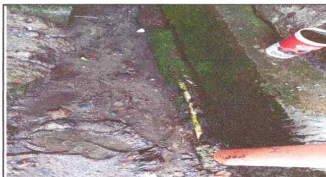
Foto 3: Tubería línea principal de agua potable en mal estado.
