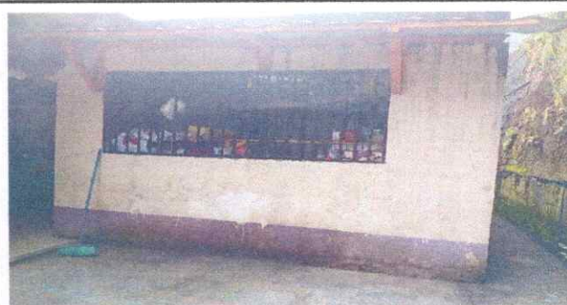
Foto 6: Paredes en mal estado
