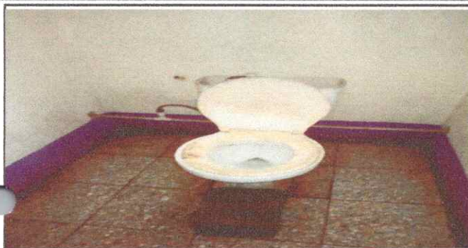
Foto1: Sustrucción de sanitarios en mal estado.
