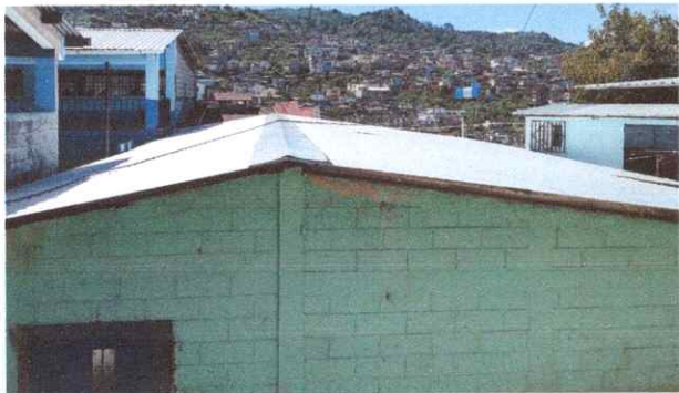
Foto No. 1 Cubierta de techo de lámina en mal estado.
