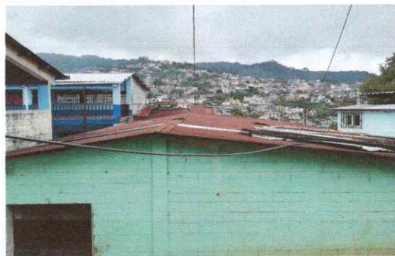
Foto No. 1 Cubierta de techo de lámina en mal estado.
