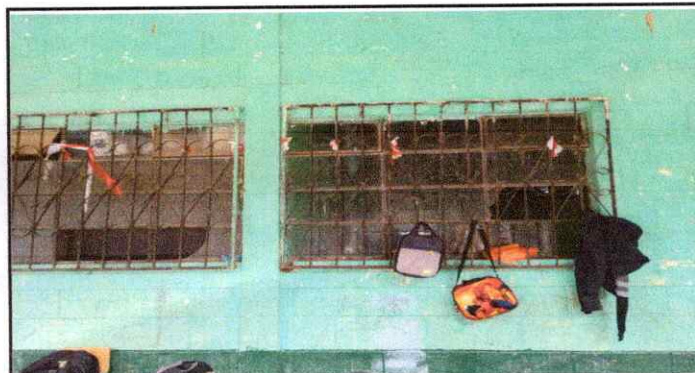
Foto 4: Balcones despintados, en mal estado y falta de vidrios en las ventanas
