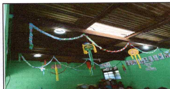
Foto 6: Cables de energía eléctrica con mala instalación
