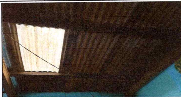
Foto 2: Soporte de madera del techado en mal estado
