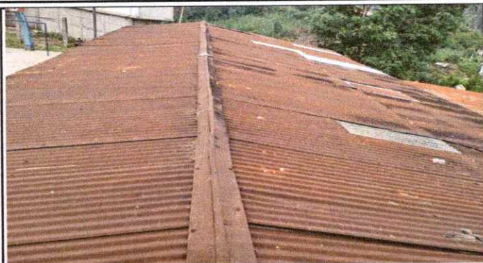
Foto1: Láminas de techo en mal estado de dos aulas
