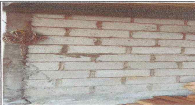
Foto NO. 10: Paredes en mal estado.
