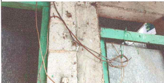
Foto No. 7: Cables en mal estado.
