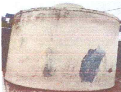
Foto No. 8: Depósitos de agua en mal estado.
