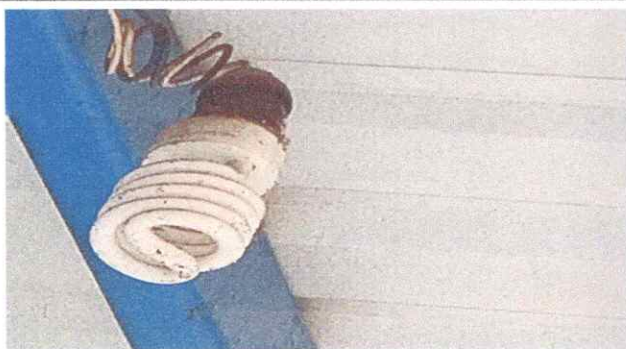
Foto No. 9: Focos en mal estado.
