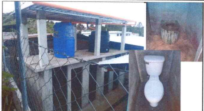
Foto 2: Letrinas construidas 1977 tipo en malas condiciones
