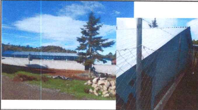
Foto1: Sustrucion de cubierta de Lámina en malas condiciones
