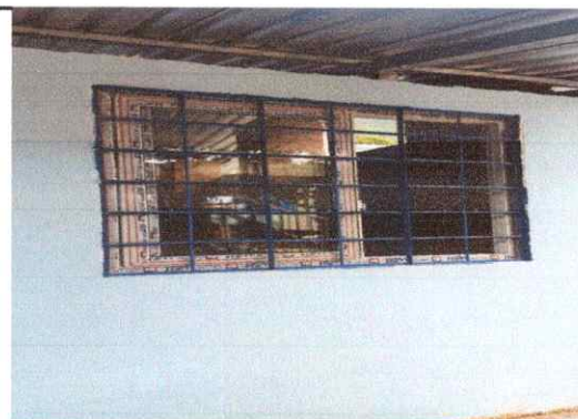
Foto No 4: Vidrios de ventanas en mal estado.
