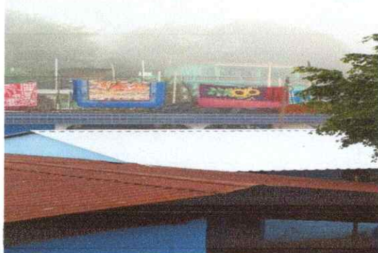
Foto No 1: Cubierta de lámina en mal estado.
