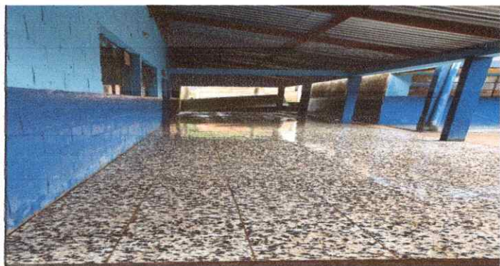
Foto No 5: Piso en mal estado.
