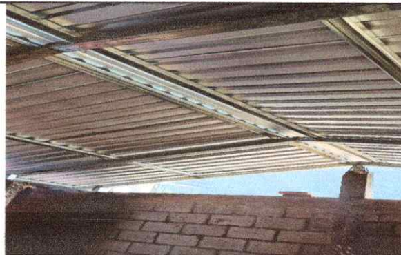
Foto No 2: Estructura de soporte de techo en mal estado.
