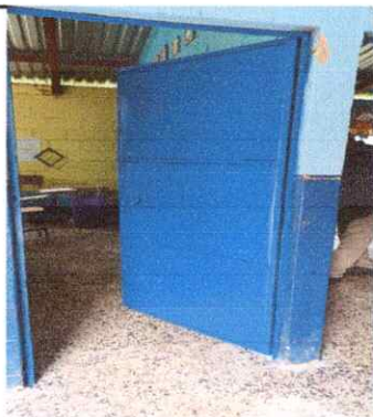
Foto No 3: Puertas de metal en mal estado.
