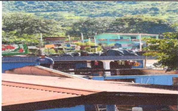
Foto No 1: Cubierta de lámina en mal estado.
