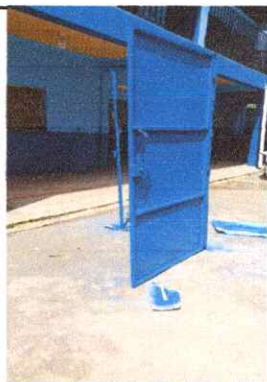
Foto No 3: Puertas de metal en mal estado.
