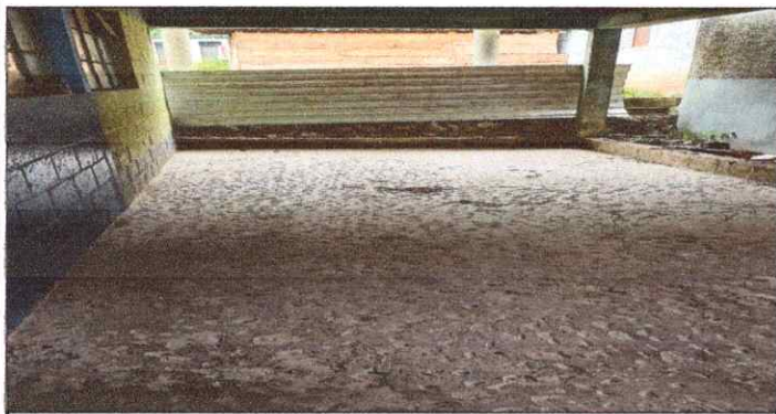
Foto No 5: Piso en mal estado.
