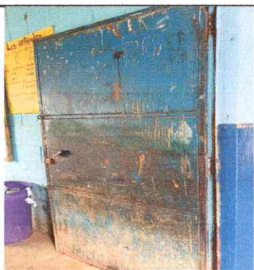
Foto No 3: Puertas de metal en mal estado.
