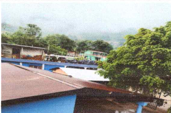
Foto No 1: Cubierta de lámina en mal estado.
