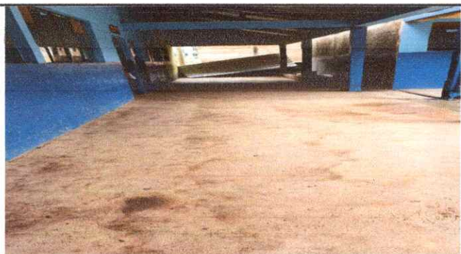
Foto No 5: Piso en mal estado.
