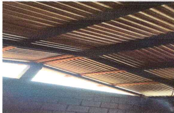
Foto No 2: Estructura de soporte de techo en mal estado.
