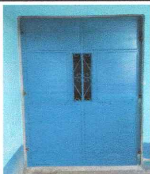
Foto No 3: Puertas de metal en mal estado.
