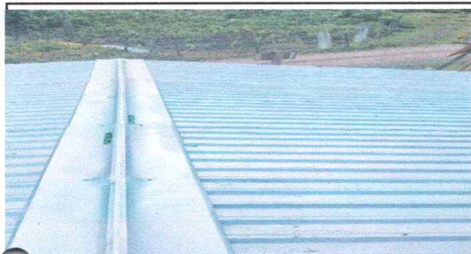
Foto No 1: Cubierta de lámina en mal estado.
