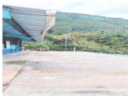
Foto No 6: Losa de patio en mal estado
