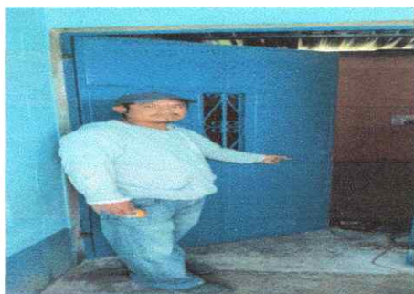
Foto No 3: Puertas de metal en mal estado.
