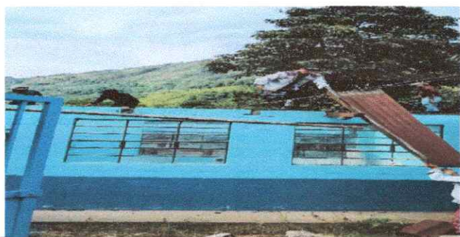
Foto No 1: Cubierta de lámina en mal estado.
