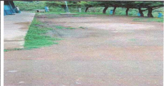
Foto No 6: Losa de patio en mal estado
