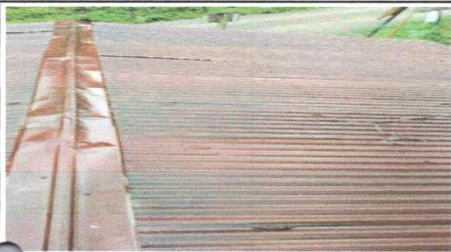
Foto No 1: Cubierta de lámina en mal estado.
