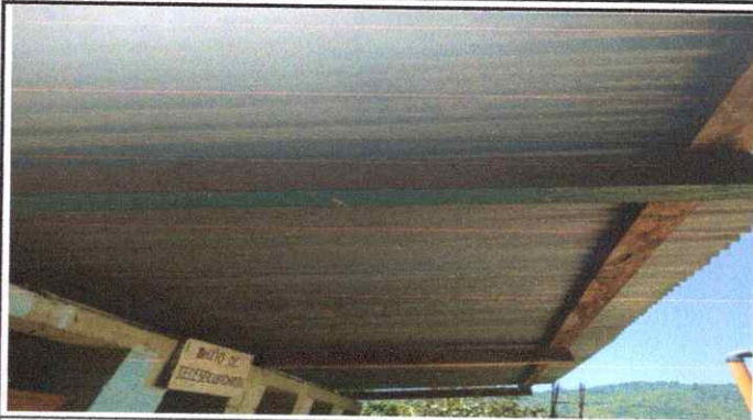
Foto1: Cubierta de lamina en mal estado.
