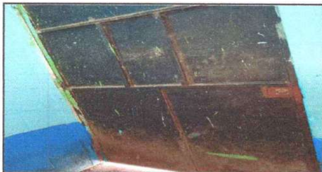
Foto No. 11: Puertas de aulas en mal estado
