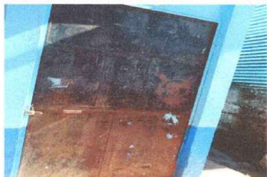
Foto No 3: Puertas de metal en mal estado.
