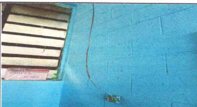
Foto No. 10: Sistema del cableado en mal estado
