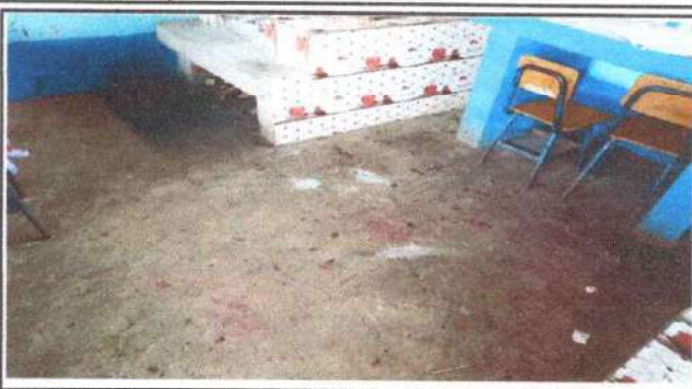
Foto No. 8: Piso de cocina en mal estado
