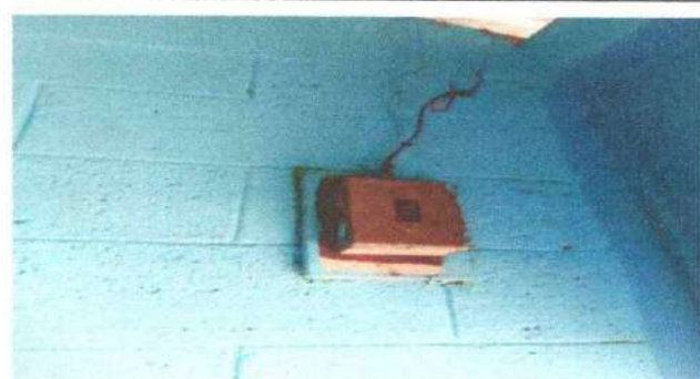
Foto No 6: Tablero de flípones en mal estado.
