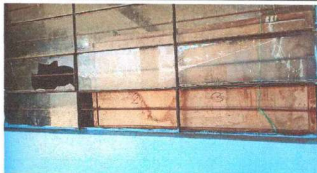
Foto No 4: Ventanas de metal en mal estado.
