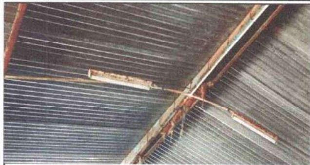
Foto No. 7: Lámparas en mal estado
