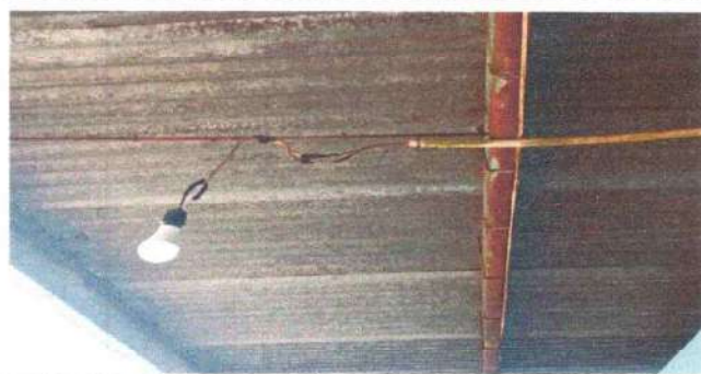
Foto No 5: Sistema eléctrico en mal estado.
