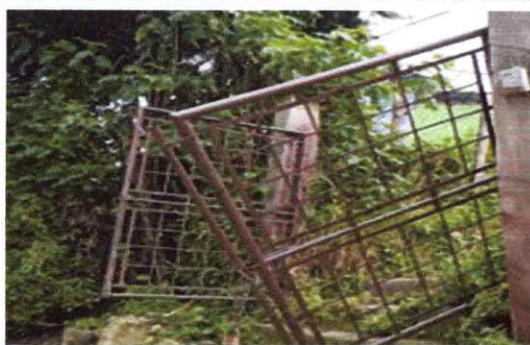
Foto 6: Renglón 3 Sustitución de portón de metal
