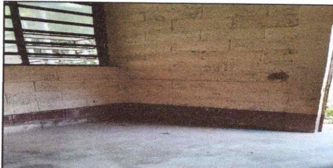
Foto No. 6: Paredes que necesitan pintura
