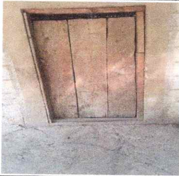
Foto No 3: Puertas de metal en mal estado.
