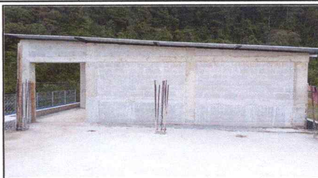
Foto 2: El canal de agua esta mal
