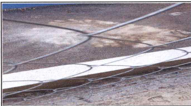
Foto 3: Baranda en mal estado
