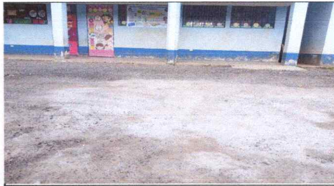
Foto 4: Piso de patio en deterioro
