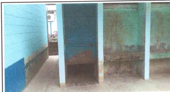
Foto No 3: Puertas de metal en mal estado.
