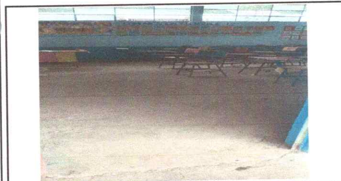
Foto No. 5: Piso de aula en mal estado
