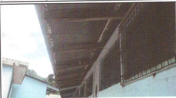
Foto No 1: Cubierta de lámina en mal estado.
