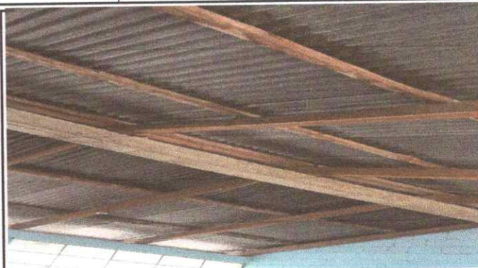
Foto No 2: Estructura de soporte de techo en mal estado.
