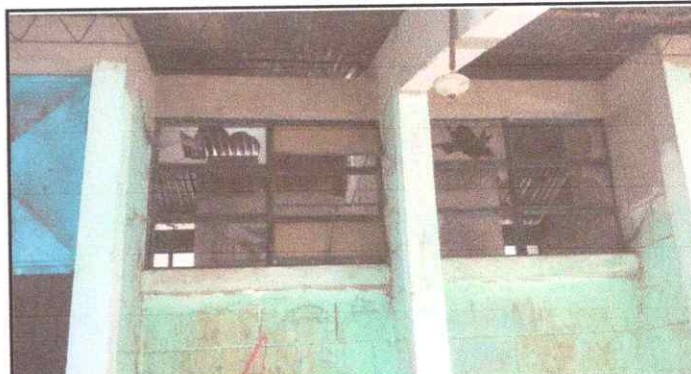
Foto No 4: Vidrios de ventanas en mal estado.
