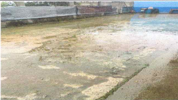
Foto 5: Piso de torta en mal estado
