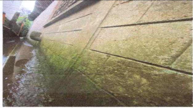
Foto 6: Paredes en mal estado
