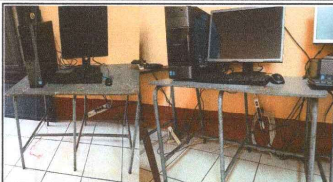
Foto 7: Área de tecnología sin tomacorrientes y cableado eléctrico adecuado.
