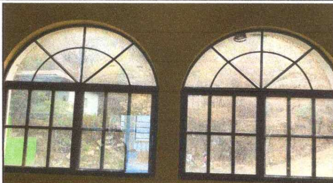
Foto 2: Las ventanas son inadecuadas, con poca ventilación.
