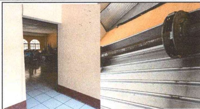
Foto 1: El establecimiento no cuenta con puertas de metal y se corre riesgo de robo. Y el portón principal está deteriorado por el tiempo de uso.
