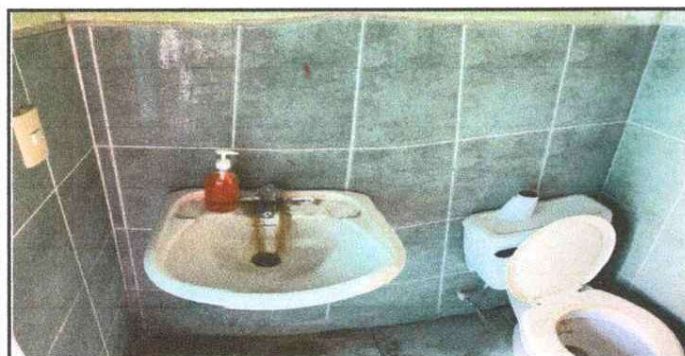
Foto 5: Baños en condiciones deplorables y en mal estado.
