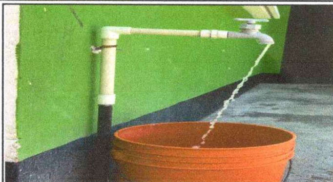
Foto 8: Falta de pila para realizar tareas de aseo personal y mantenimiento higiénico del establecimiento educativo.
