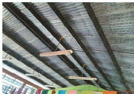
Foto 2: Costaneras en mal estado
