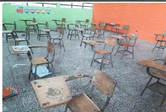
Foto 4: Piso en mal estado
