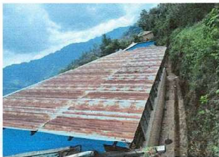
Foto1: techo en mal estado
