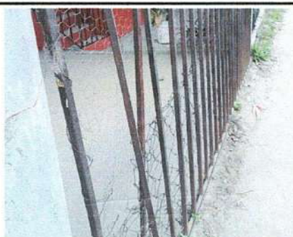
Foto 6: Barandales en mal estado
