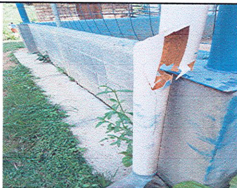
Foto 3: Descripción: se va a corregir y cambiar las tuberías de las bajadas de aguas fluviales ya que están muy dañadas.
