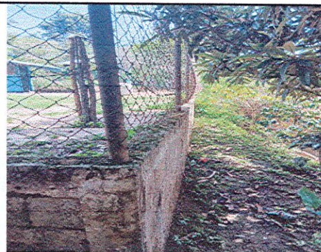
Foto 4: circulación en malas condiciones
