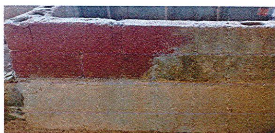
Foto No. 5 Pila en mal estado.
