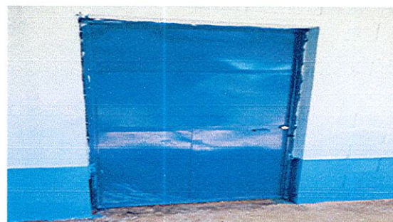
Foto 4: Sustrucciones de puertas metalicas
