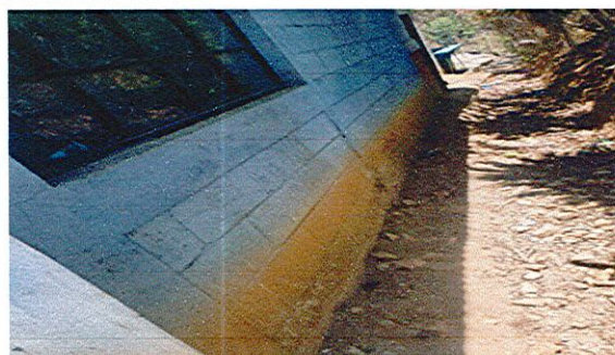
Foto 6: Sustrucción de pintura
