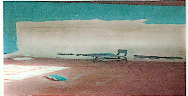
Foto 4: Refleja el estado deteriorado en que se encontraba la estructura del Instituto, evidenciando las condiciones poco adecuadas que afectaban el entorno educativo de nuestros estudiantes.
