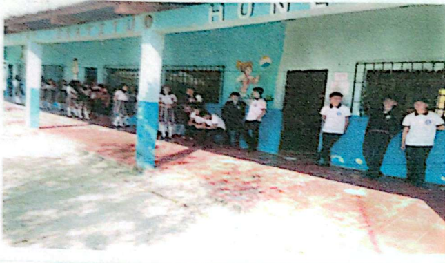
Foto 3: Como parte del diagnóstico general de la infraestructura del establecimiento, se ha constatado un notable deterioro en la pintura de las instalaciones, tanto en las áreas interiores como exteriores.
