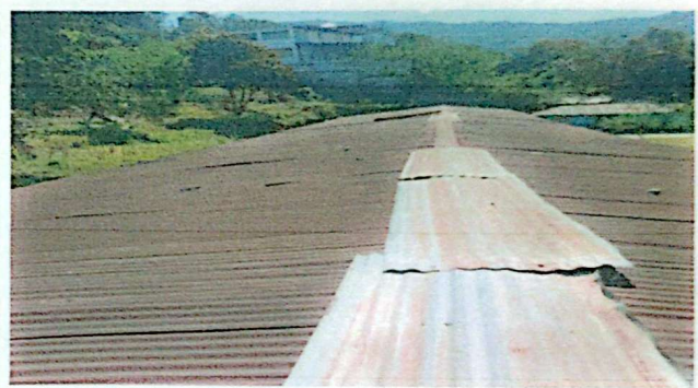
Foto 4: Se colocarán capotes en el techo para brindar mayor protección, ya que actualmente solo cuenta con lámina.
