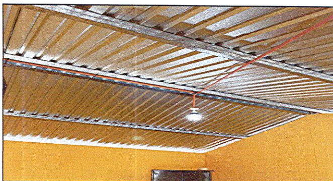
Foto 10: SISTEMA ELÉCTRICO E ILUMINACIÓN FINALIZADOS
