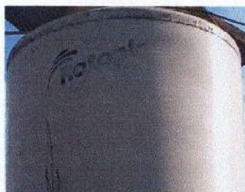
Foto No. 10: Depósito de agua deteriorado
