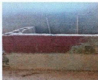
Foto No. 5: Pila en mal estado.
