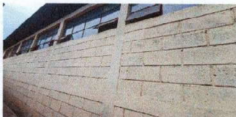
Foto No. 7: Falta de pintura y pintura deteriorada
