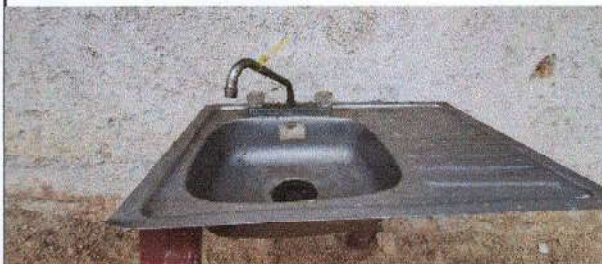
Foto No. 6: Lavamanos en mal estado
