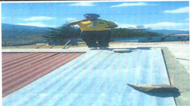
Foto 1: Las láminas muestran señales visibles de oxidación, filtraciones de agua durante la época de lluvia, y desprendimientos parciales que ponen en riesgo la integridad física de los estudiantes, docentes y personal administrativo.
