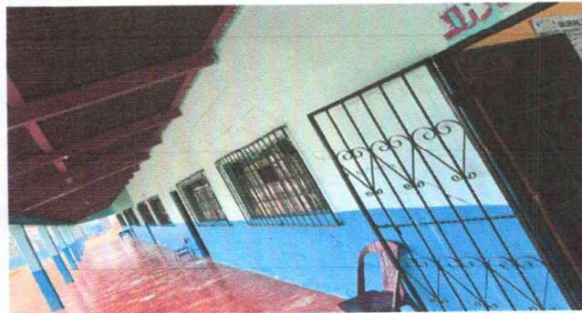
Foto 2: Ante esta situación, se propone sustituir dichas reglas por costaneras metálicas, que ofrecen una mayor durabilidad, resistencia estructural y estabilidad ante las condiciones climáticas de la región.
