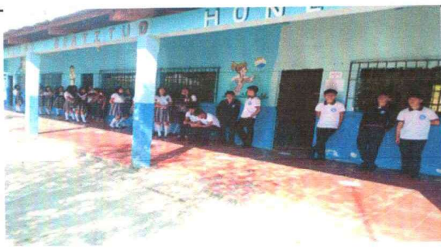
Foto 3: Como parte del diagnóstico general de la infraestructura del establecimiento, se ha constatado un notable deterioro en la pintura de las instalaciones, tanto en las áreas interiores como exteriores.
