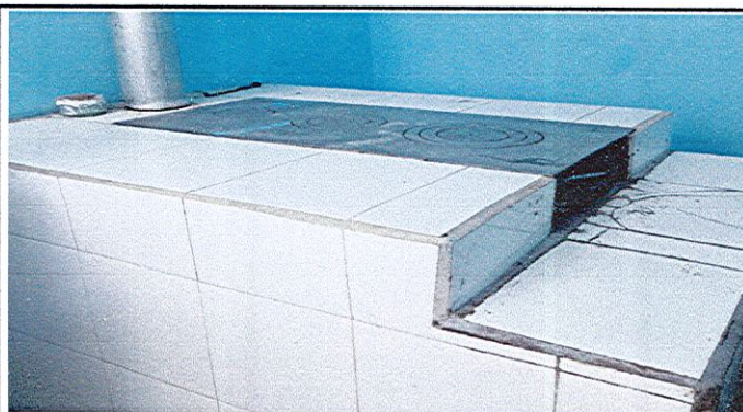
Foto 3: Se sustituyó la plancha de metal de 3 hornillas.
