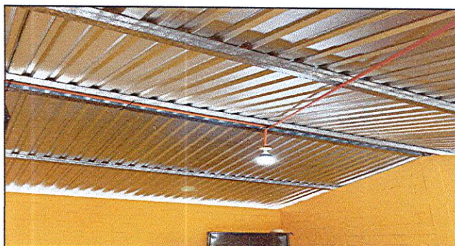
Foto 10: SISTEMA ELÉCTRICO E ILUMINACIÓN FINALIZADOS
