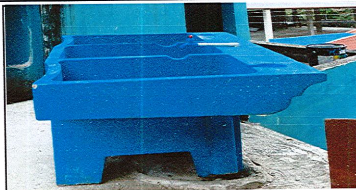
Foto 8: Pila con sus accesorios y lavaderos para el servicio del centro educativo.
