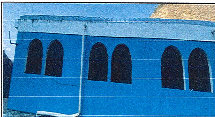
Foto 3: Las ventanas del NUFED están sin balcones de protección.
