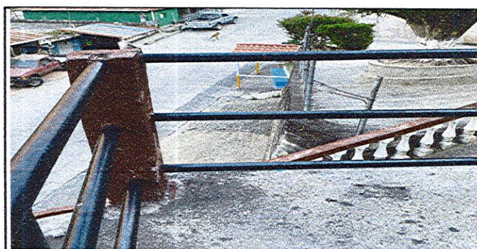
Foto 6: Existe una baranda que debe ser mejorada porque los estudiantes se suben en ella y corren riesgo.
