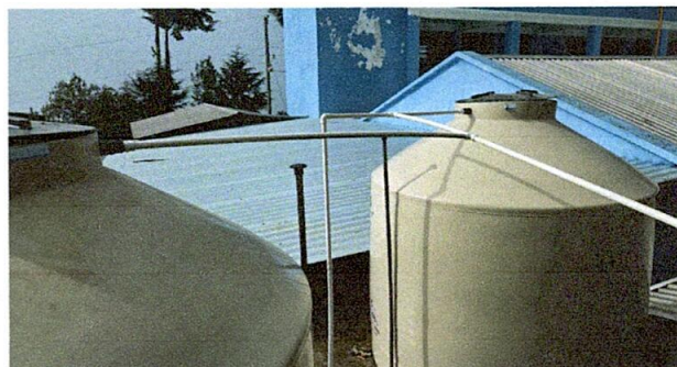
Foto 2: DEPÓSITOS DE AGUA INSTALADOS
